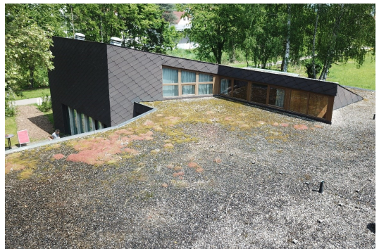
Bild: Das zu sanierende Flachdach auf dem Gemeindehaus
